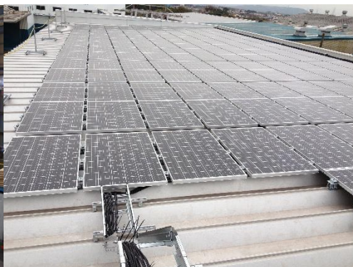
↓太陽光パネル
